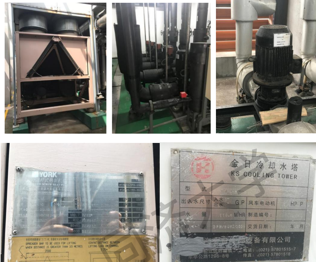
图 6.5 测试建筑设备实际图
