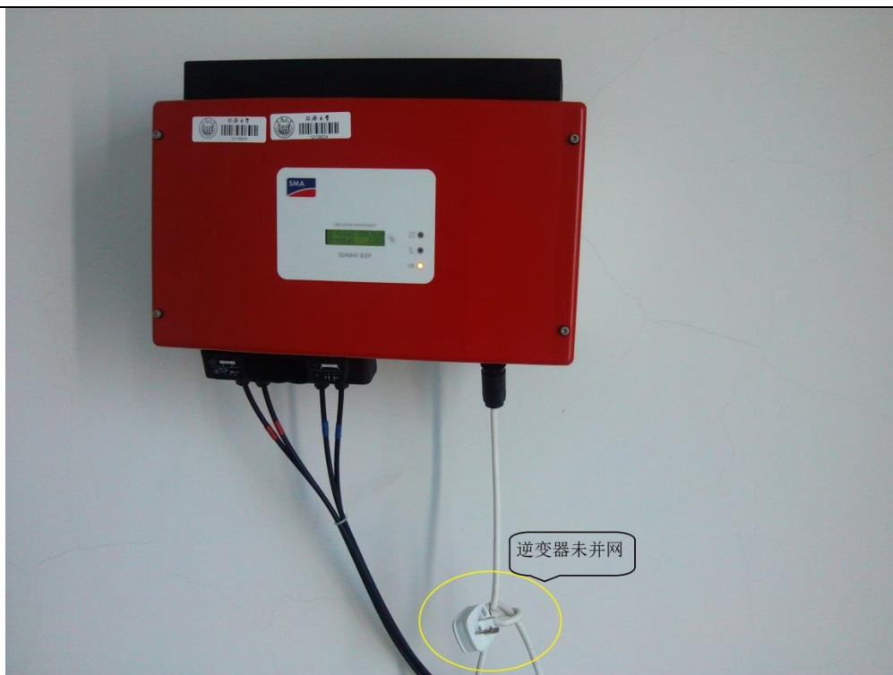
图 5-33 逆变器关闭实验的故障方式
